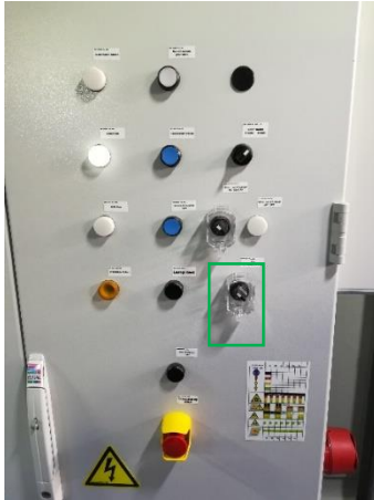
Armario TopBox2, se resalta el selector que controla la alimentación del giro del yaw
